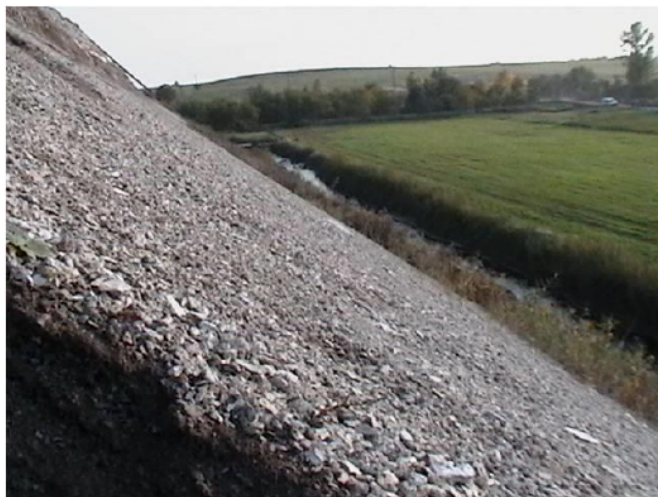
10. ábra. A gátlábi törmelék felpöndörödött lemezkéi [The curled plates on the under-dam detritus] (Jordán Gy. 2010. nov. 5.)
